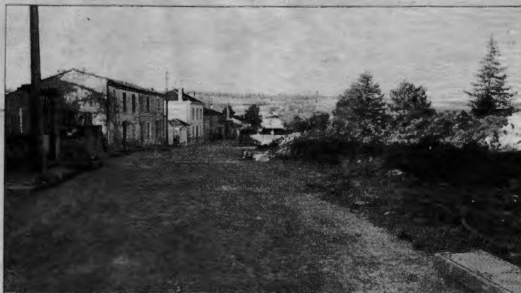
Les travaux effectués rue de Verdun devraient être totalement terminés en juin.
