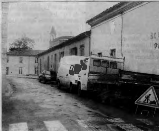
La rue de Verdun en travaux pour quatre mois (Photo William Biard)
