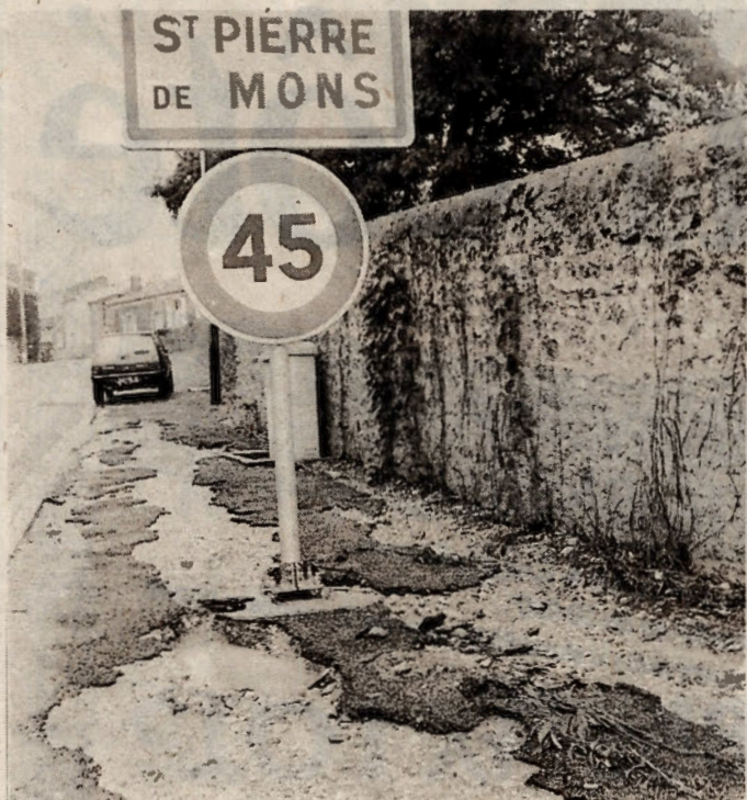
Les services de voirie communale et de l'équipement auront désormais fort à faire. Ici, à Saint-Pierre-de-Mons, les trottoirs sont détruits
