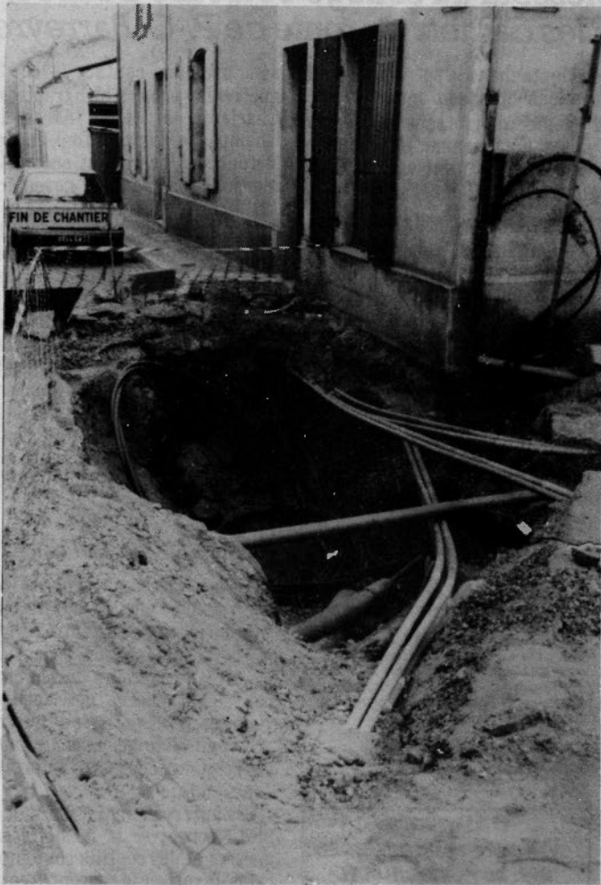
Une forêt de câbles jalonne le sous-sol du cours de la République (Photo J. S., «S-O»)
