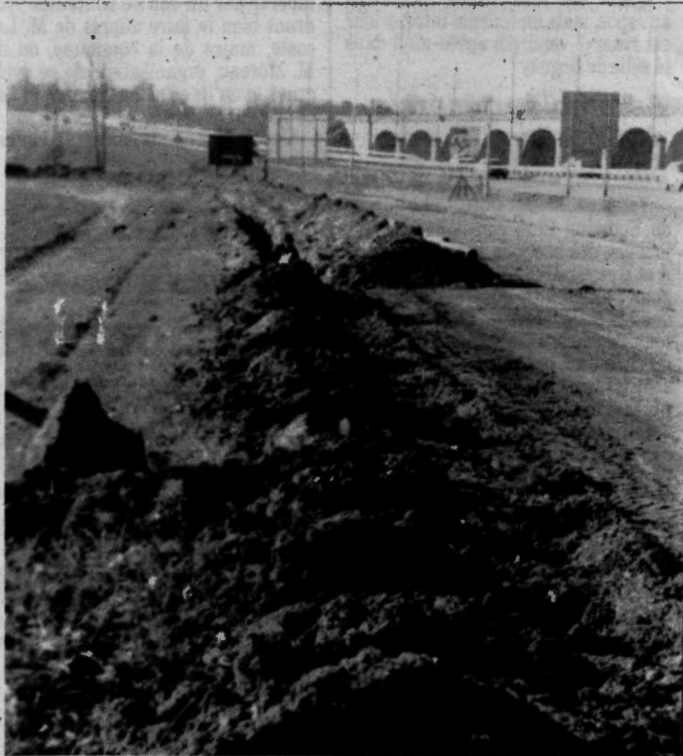
La canalisation de refoulement et son tracé en direction du nouveau pont
